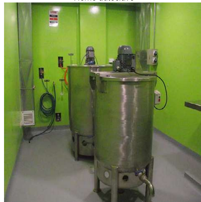
Tanques de acero
